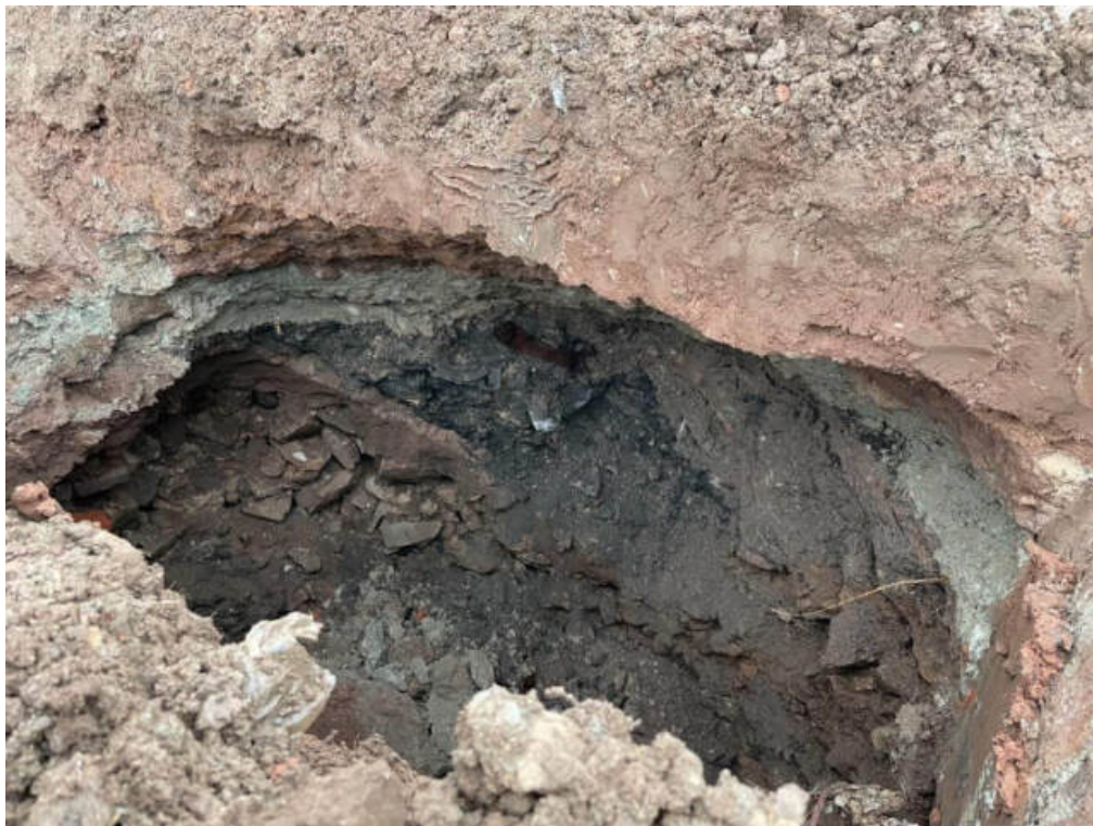
Abb. 1: Schurf SCH 1, Westrand ehemaliger Steinbruch (älterer Teil), bauschutthaltige Auffüllungen bis ca. 6,7 m u. GOK
