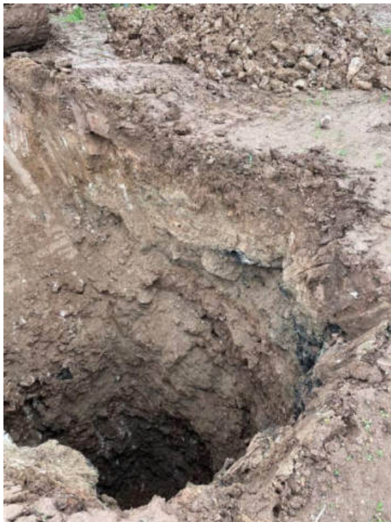
Abb. 9: Schurf SCH 4, Südliche Flurgrenze Nähe Bestandsbebauung sowie östlicher Abbruchkante ehemaliger Steinbruch (älterer Teil), obere Auffüllungsschicht. Ab ca. 0,6 m tritt vermehrt Bauschutt (überwiegend Asphaltbruch) auf.
